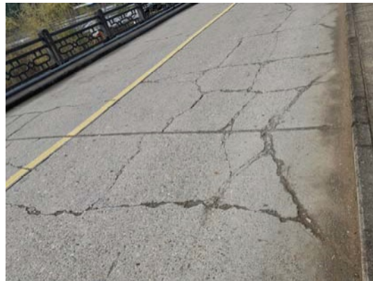
图1 旧桥桥面开裂
